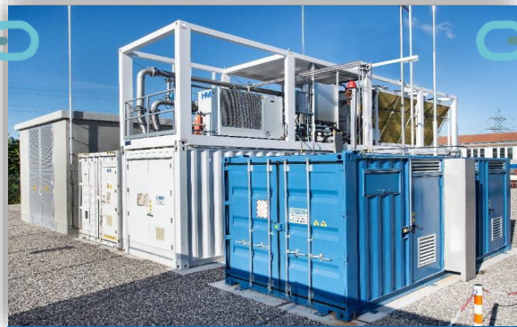
Elettrolizzatore da 2 MW
